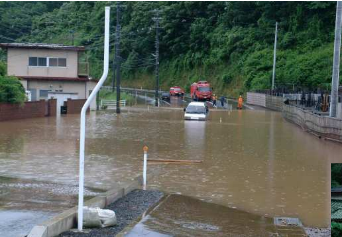
道路が浸水し、車両通行が不能
