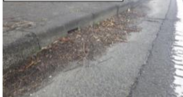
路面へゴミや土砂が堆砂
