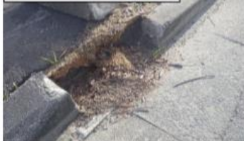
暗渠管が土砂等により閉塞
